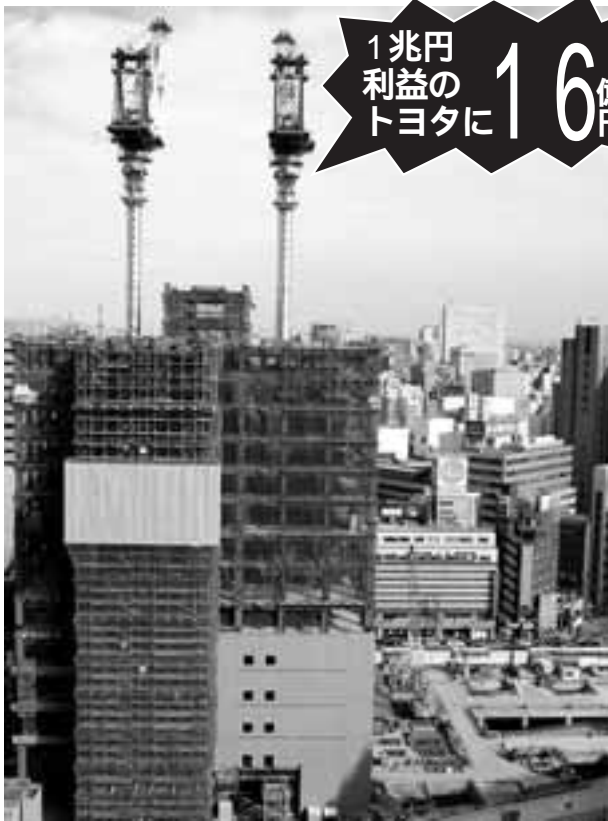
急ピッチで建設が進められる「新豊田・毎日ビル」。ここにはトヨタの海外事業部門が入居する
